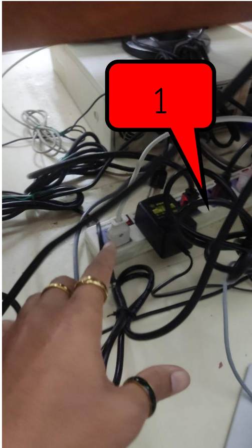
1. กดสวิตช์เปิดบนรางไฟทุกสวิตช์
